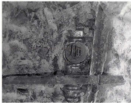
Fig. 4: Geöffneter Hochpunkt eines Spanngliedes Fig. 4: Opened high point of a tendon
