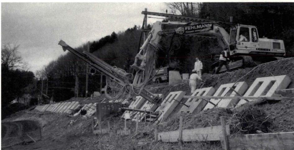
Ansicht einer Teilstrecke der Baustelle. Im Vordergrund der Bagger mit der speziellen Bohrlafette, mit der Angriffspunkte bis 5 m unterhalb der Plattform und 8 m aus der Baggerachse erreicht werden können. View of part of the construction site. In the foreground is the excavator with the special drilling carriage, with which drilling points 5 m below the platform and 8 m out of the excavator axis can be reached.
