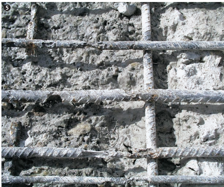
Korrosion in der Bewehrung. Corrosion of reinforcement.
