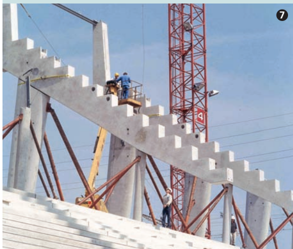
Rahmen aus oberen Tribünensträgern und Stützen im Montagezustand. Upper girder and columns.
