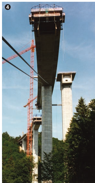
Vue frontale des dispositifs de stabili- sation des fléaux (haubans et entretoises). Front view of temporary stabilisation devices of cantilever structures (stay cables and transverse steel beams).
