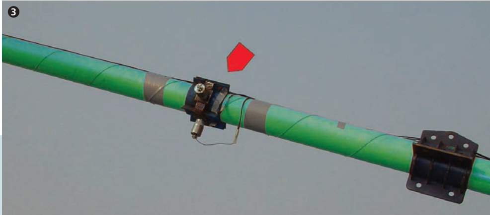
3 Beschleunigungsaufnehmer auf einem Schrägseil, installiert für einen Schwingungsversuch. Accelerometers installed on a stay cable for an ambient vibration test.
