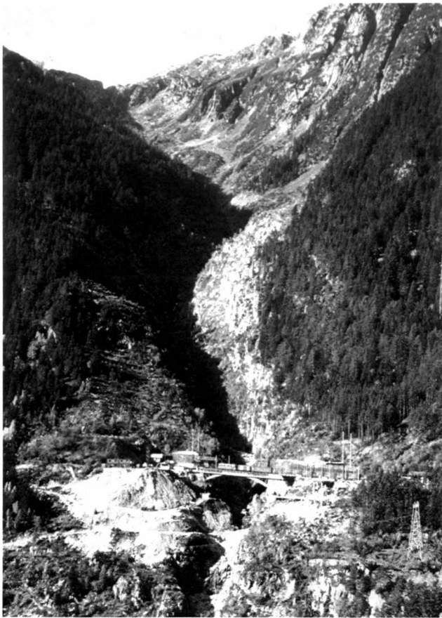
Fig.2. Ansicht der Baustelle mit Einzugsgebiet der Lawinen (oben) und Lawinenzug begrenzt durch den noch stehenden Wald – Vue du chantier avec la zone exposée à la chute des avalanches (en haut) et le couloir délimité latéralement par la forêt encore existante – View on site avalanche exposed zone (above) and the clearing due to avalanches delimited by the still standing forest
