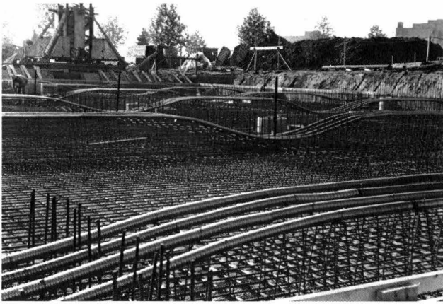
Fig. 1. Fundamentplatte Block B. Untere Armierung und Kabel Typ BBRV 1000 – Dalle de fondation du bloc B. Armatures inférieures et câbles de précontrainte BBRV 1000 – Foundation slab of block B. Bottom reinforcement and type BBRV 1000 prestress cable.
