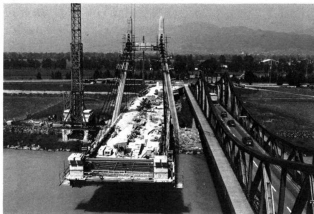
Fig.5. Ansicht des Freivorbau – Vue de la construction en porte à faux – View of cantilever construction
