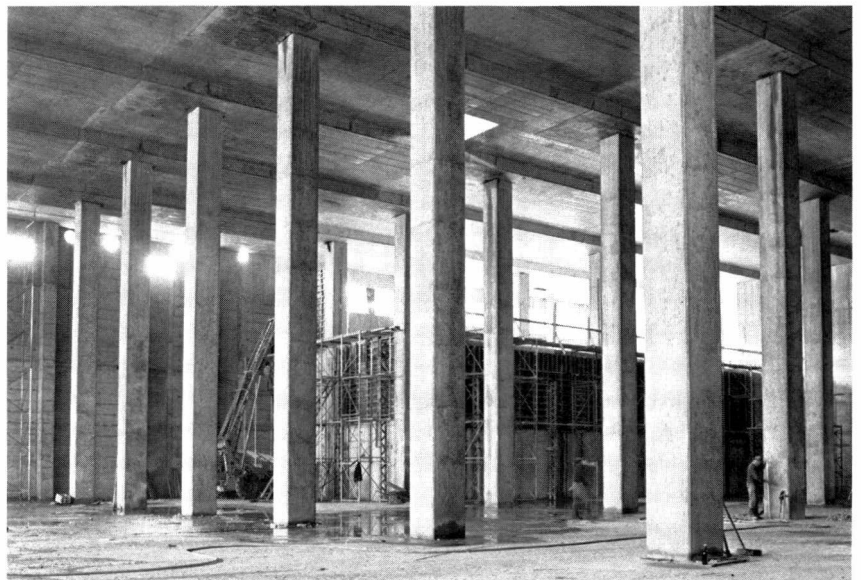
Fig. 2. Vorgespannte Unterzugsdecke auf den 13 m hohen Stützen im Untergeschoss – Dalle à sommiers précontraints reposant sur les piliers du sous-sol de 13 m de hauteur – Post-tensioned slab on beams, resting on 13 m high columns in the basement
